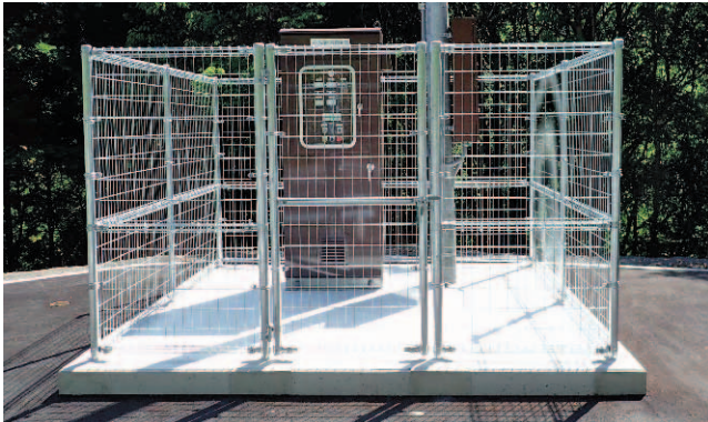
図-3 操作制御盤 外観
