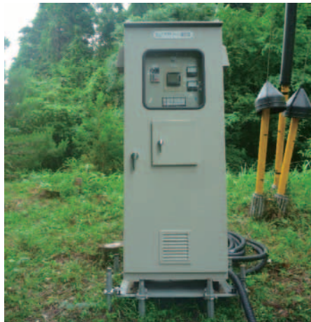
図-4 操作制御盤 外観
