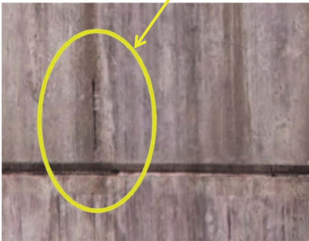
図-10 目視調査では記録できていなかった変状例
