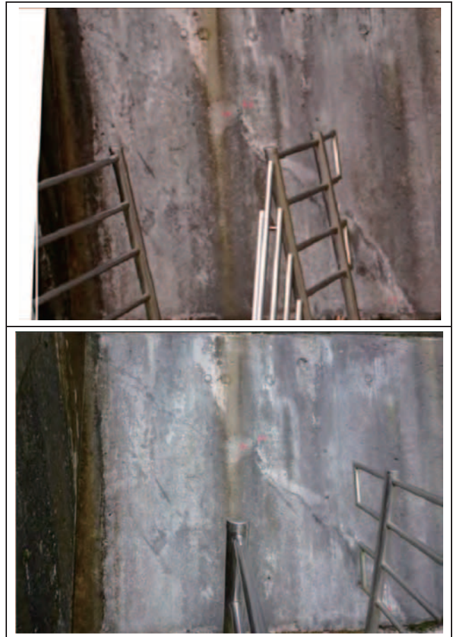
図-8 クラック画像の比較 (上:合成写真、下:デジタルカメラ)
